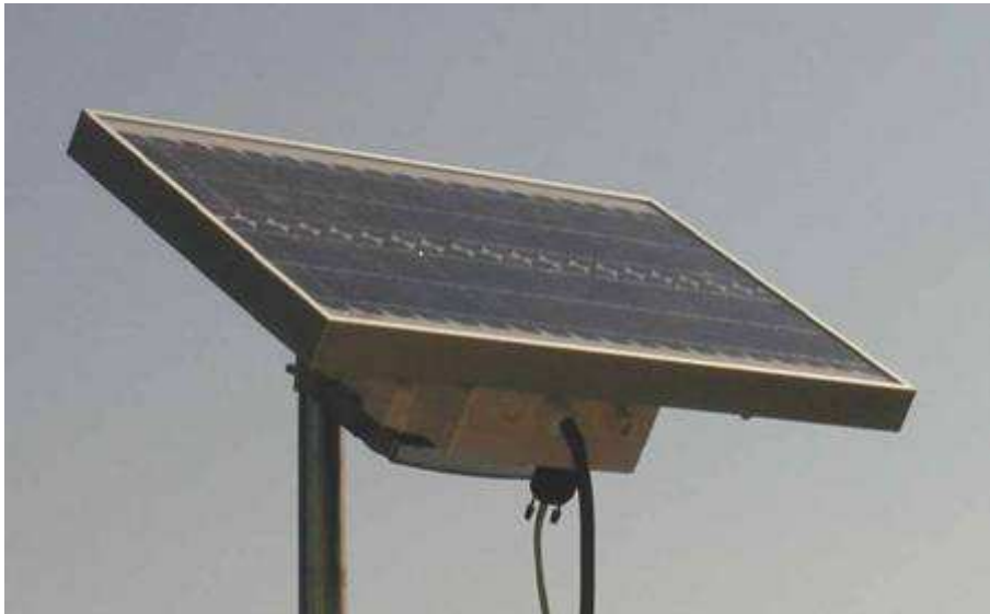
Panneau solaire, batterie, modem GPRS
